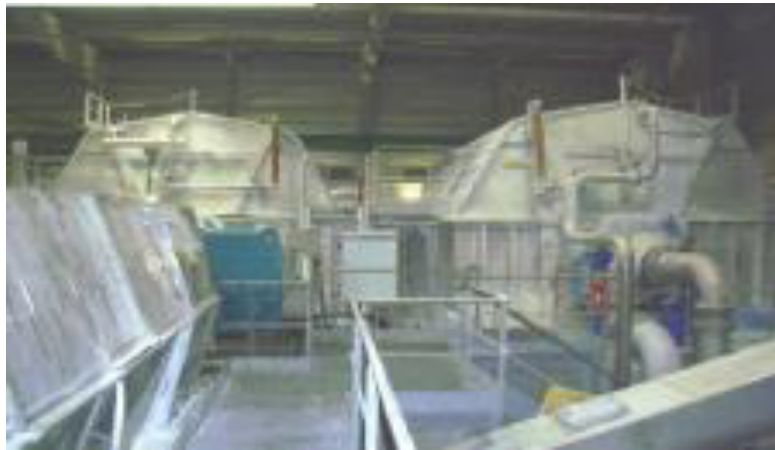
Figure 20 : Photographie des filtres à disques épauisseurs
